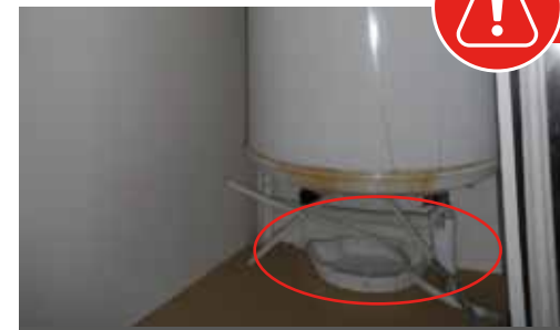
ESPACE INSUFFISANT SOUS LE CHAUFFE-EAU
