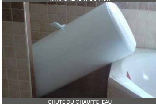
CHUTE DU CHAUFFE-EAU
