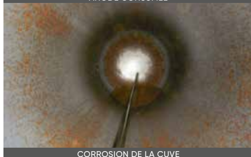
CORROSION DE LA CUVE
